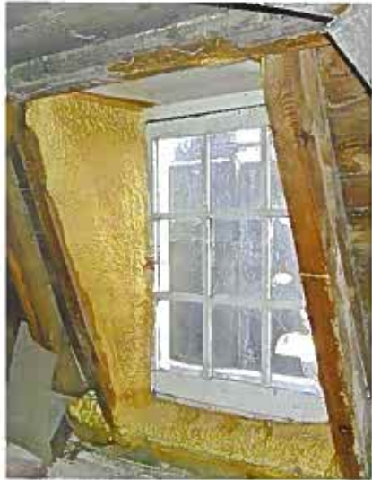
Een bizarre 'isolatieronde' in de zeventiende-eeuwse kap van een topmonument. Dakkapelwanden en kieren onderaan de kapvoet zijn volgeschuimd met PUR. Maar de beglazing van het raam is in enkelglas en de dakhuid is ongeïsoleerd gebleven. Er is geen enkele energetische winst geboekt en de kapconstructie zal binnen enkele decennia zijn aangetast door houtrot. Foto Taco Hermans.
